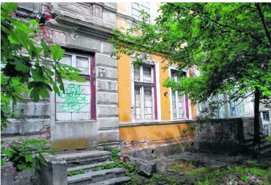
In Kolberg entdeckte die Reisegruppe halb verfallene Häuser. Wenn das Geld fehlt, wird alte Bausubstanz einfach ihrem Schicksal überlassen.
